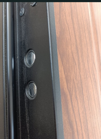
Particolare dei doppi deviatori
